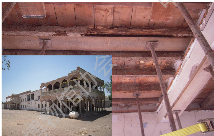
遗产建筑的木结构被白蚁破坏（图片由小何塞·路易斯·佩德索利提供）
